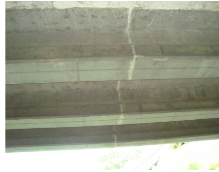
【主桁剥離鉄筋露出状況】
